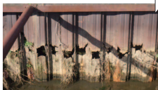
極度の腐食を受けた鋼矢板護岸
