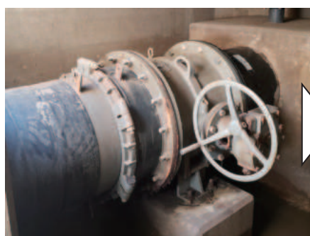
農業用パイプラインの一例
