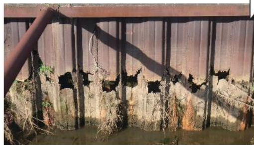
極度な腐食を受けた鋼矢板護岸
