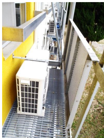
窓の外 (室外機)
