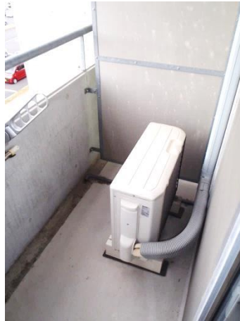
ベランダ (室外機)
