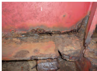
経年劣化により深刻な損傷を受けた鋼橋の例 〔下フランジの破断、ウェブ下部の破断、重直補脚材の減厚、支承機能の喪失〕
