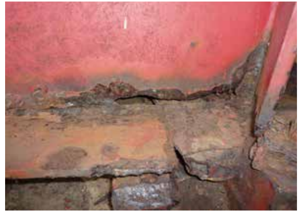
経年劣化により深刻な損傷を受けた鋼橋の例 (下フランジの破断、ウェブ下部の破断、垂直補剛材の減厚、支承機能の喪失)
