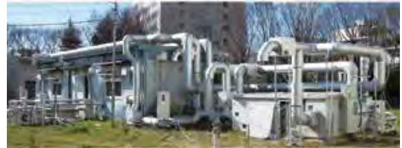
ヒートポンプ組み込み型デシカント空調システムの実験施設（東京大学生産技術研究所）
