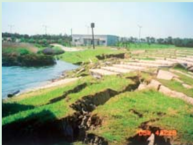
写真3 福岡県海の中道海浜公園で発生した盛土崩壊
